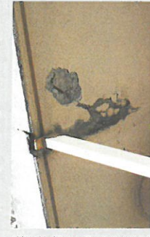
鉄骨がむき出しになった エレベーターの軒
